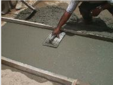
Se nivela y flota el concreto mediante un cepillo de plastico para evitar oquedades en la superficie
